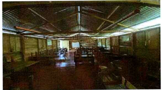
Foto 4: Se mejorará el piso del aula.
